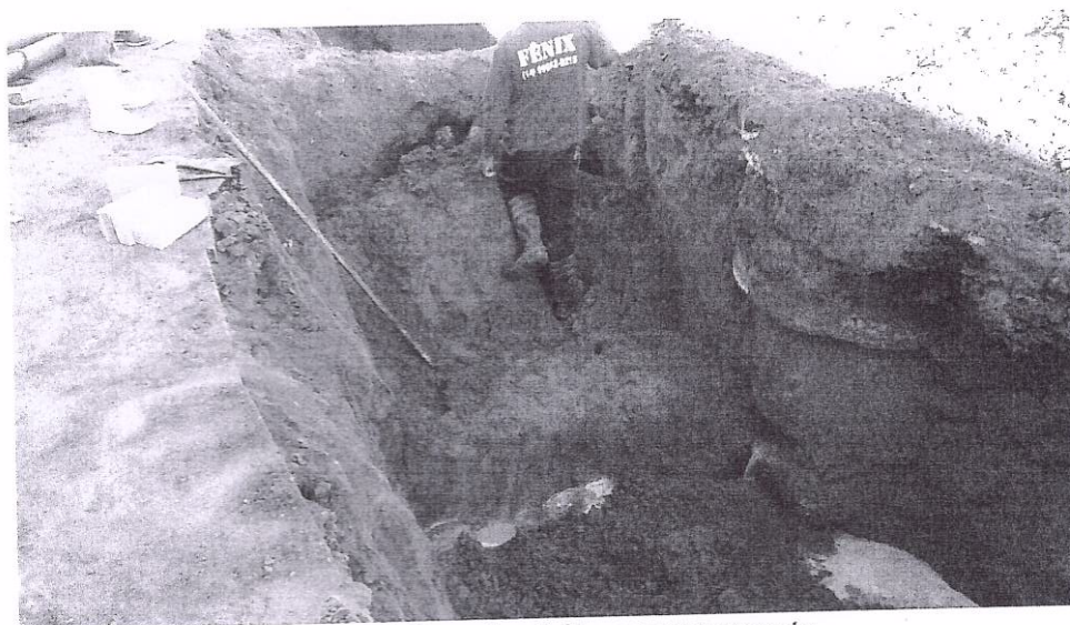
Figura 3: Poço de visita com vazamento
