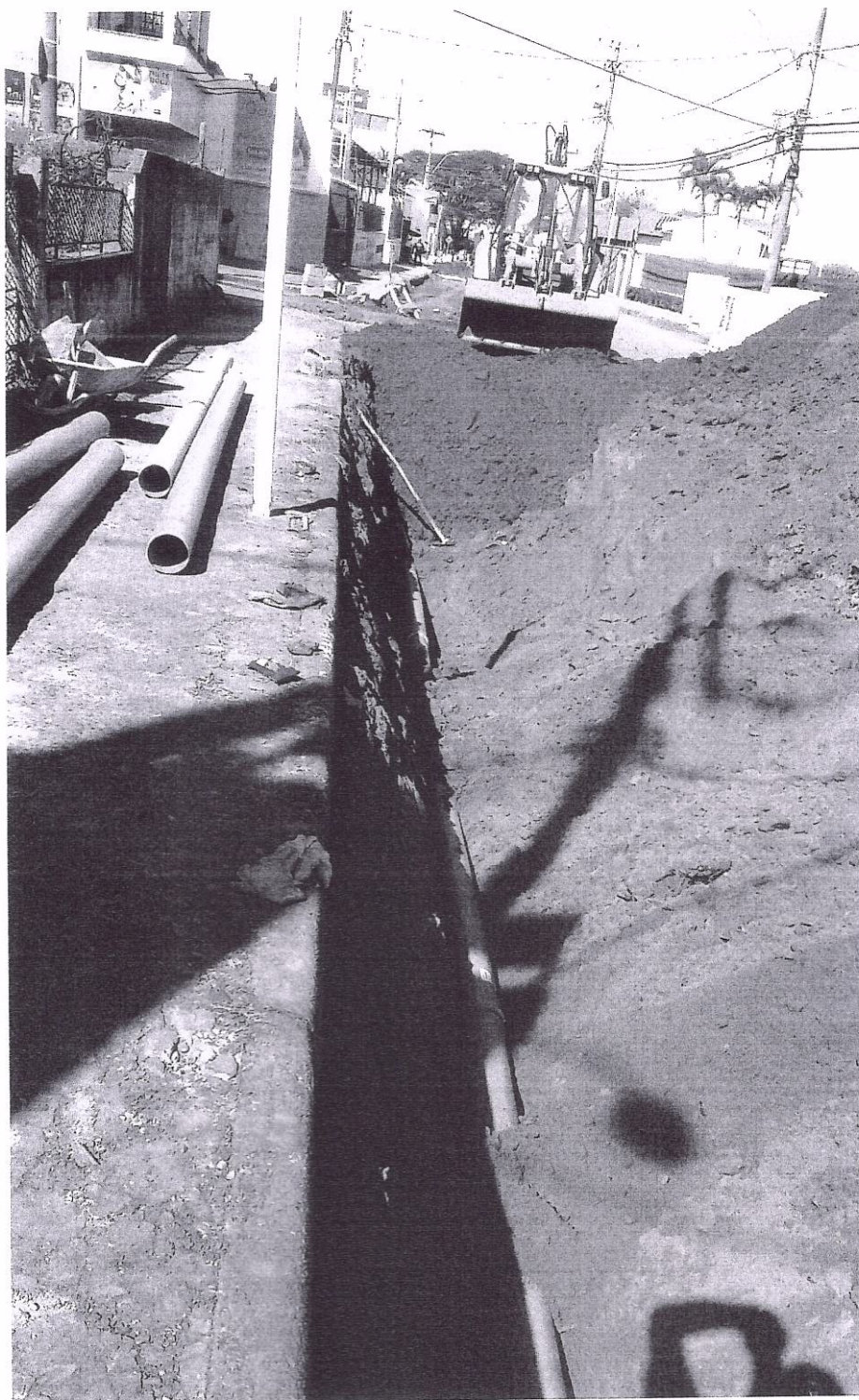
Figura 1: Rede coletora de esgotos colocada sobre a Galeria
