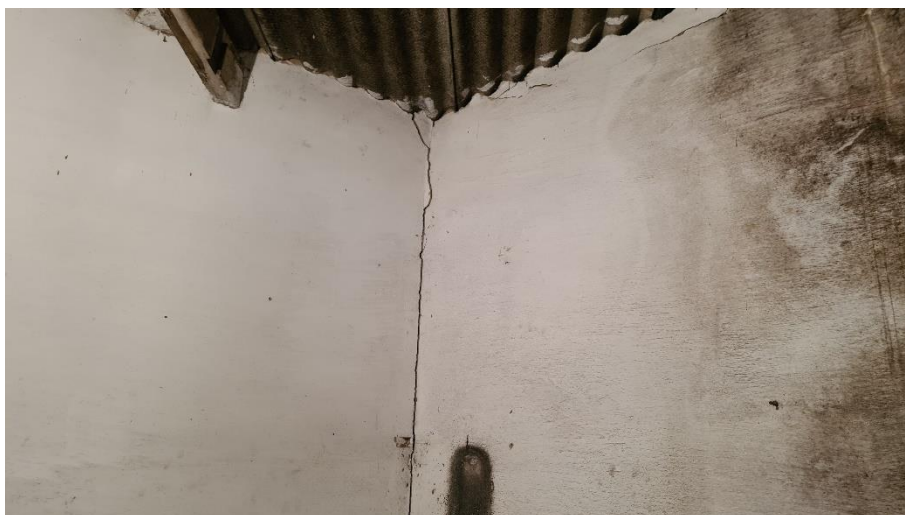
Imagem 3: Imagem com vista da área interna do imóvel onde pode ser observado trincas junto ao telhado da garagem e na junção das paredes.
