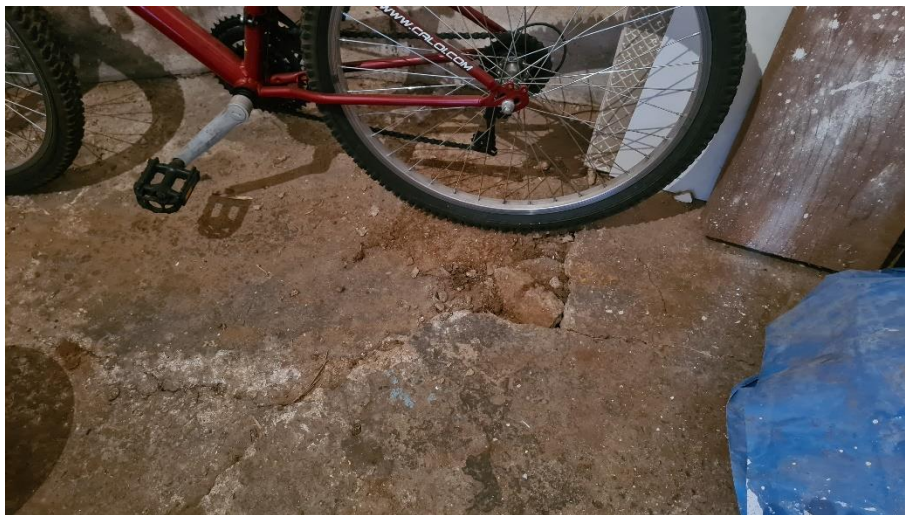
Imagem 2: Imagem com vista da área interna do imóvel onde pode ser observado rachaduras junto ao piso do quintal.
