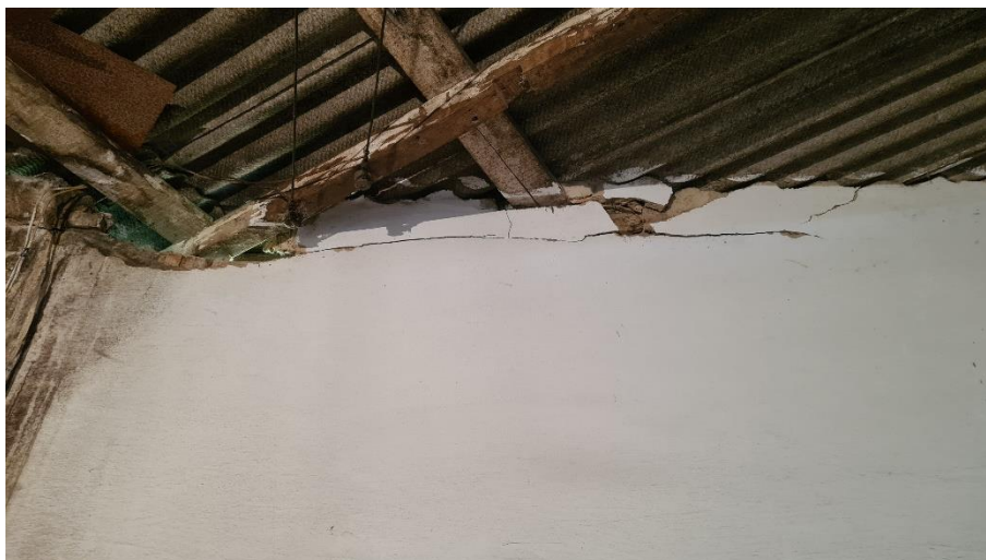
Imagem 1: Imagem com vista da área interna do imóvel onde pode ser observado trincas junto ao telhado da garagem.
