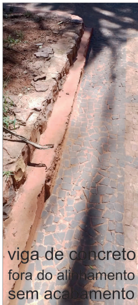
viga de concreto fora do alinhamento sem acabamento
