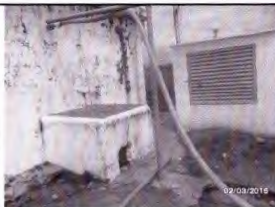
Foto 14 – Centro de reservação Cesar Neto: estrutura civil do piso danificada.
