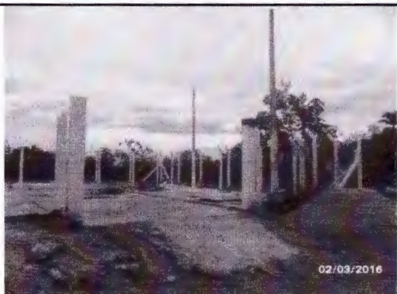
Foto 45 – EEE 2 – inexistência de barreira física - portão.
