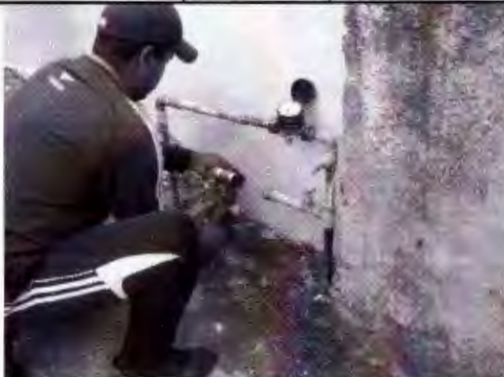
Foto 13 – Foram executadas duas ações para inibir a situação: trocados os hidrometros e retiradas as torneiras dos cavaletes.
