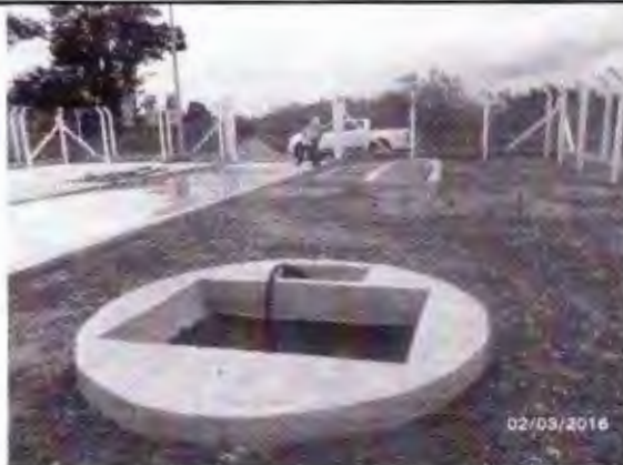
Foto 41– Rio Bonito: EEE 4: inexistência de proteção no poço de sucção – riscos de acidente.
