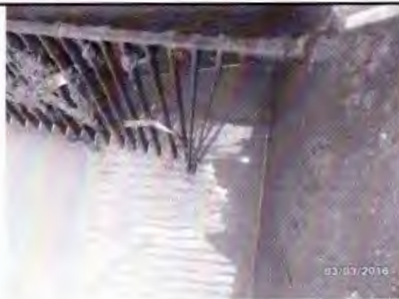
Foto 30 – EEE Jardim Riviera: extravazamento de esgotos.
