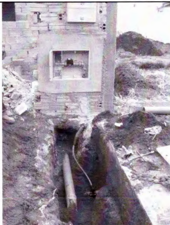
Foto 7 – Ligação de água e esgoto.
