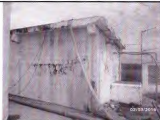
Foto 12 – Reservatório de água tratada: estrutura civil danificada.
