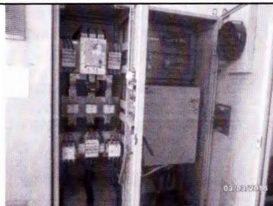
Foto 2 – EEAB Rio Pardo: quadro de comando elétrico.
