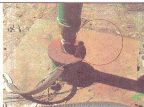
Foto 28 – Poço de Vitoriana: inexistência de proteção no tubo de nível
