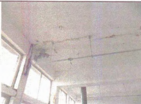
Foto 7 – ETA: fissuras na estrutura civil do reservatório elevado de água para lavagem dos filtros.
