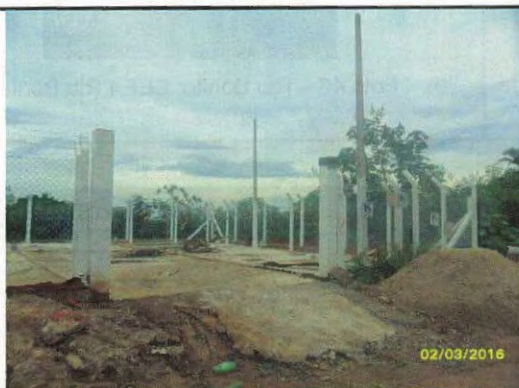
Foto 45 – EEE 2 – inexistência de barreira física - portão.
