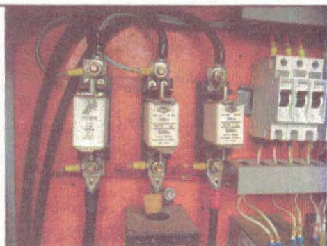
Foto 78 – Jardim Botucatu III: – quadro de comando elétrico: partes vivas expostas e fusíveis com diferentes amperagens.
