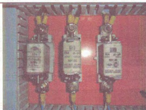
Foto 24 – Quadro de comando elétrico da casa de química.
