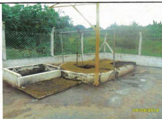
Foto 27 – ETE Jardim Riviera: vista geral.
