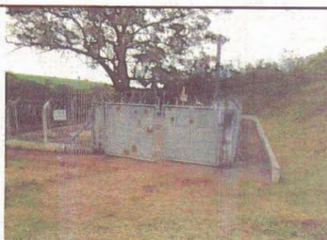
Foto 61 – EEE Monte Mor: vista geral
