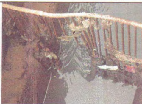
Foto 85 – EEE Jardim América: gradeamento danificado.
