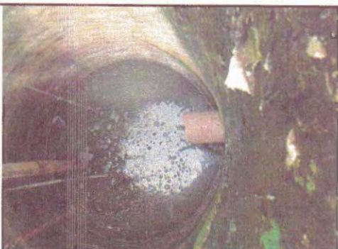
Foto 49 – EEE Jardim Tropical: poço de sucção.
