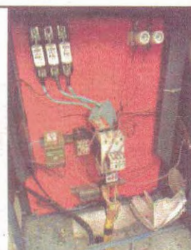
Foto 52 – EEE Capão Bonito.
