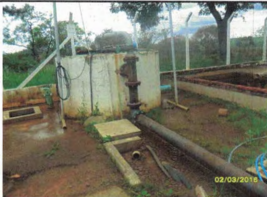
Foto 15 – ETA Rio Bonito - Caixa de contato.
