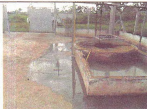
Foto 40 – EEE Jardim Riviera: extravazamento de esgotos.
