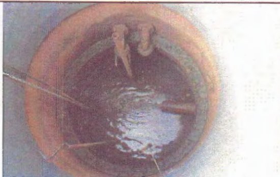
Foto 35 – EEE Convívio: poço de sucção.
