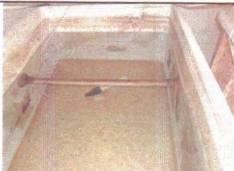
Foto 17 – reservatório de produto químico.
