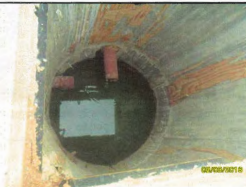
Foto 42 – Rio Bonito EEE 4 – inexistência de proteção no poço de sucção – riscos de acidente.
