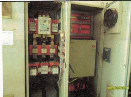
Foto 2 – EEAB Rio Pardo: quadro de comando elétrico.
