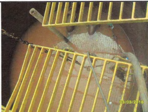
Foto 29 – EEE Jardim Riviera: poço de sucção.
