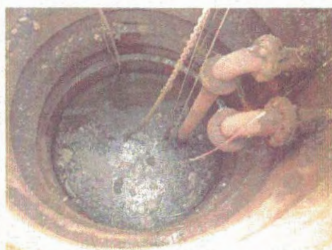
Foto 66 – EEE Bela Vista: poço de sucção.
