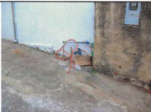
Foto 11 – Suspeita de hidrometro avariado neste cavalete multiplo informado pelo leiturista.
