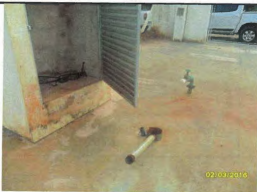
Foto 5 – Poço P4 e quadro de comando elétrico.
