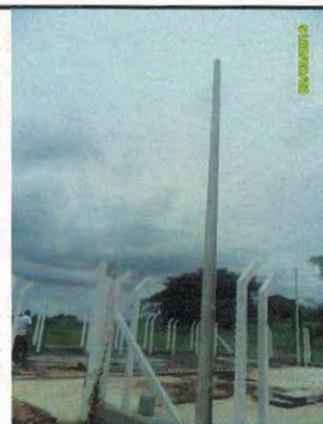
Foto 40 – Rio Bonito: EEE4 Rio Bonito.
