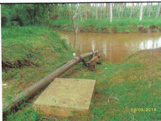
Foto 1 – Captação: Pinheirinho/Rio Pardo II.
