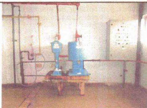
Foto 3 – ETA: suporte do PAC danificado.
