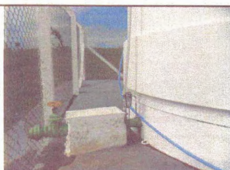
Foto 22 – reservatório de água tratada: vazamento através do registro.
