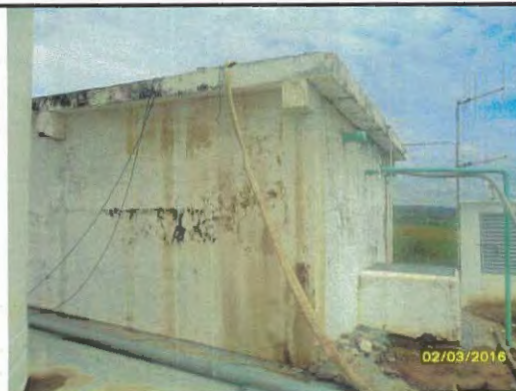
Foto 12 – Reservatório de água tratada: estrutura civil danificada.
