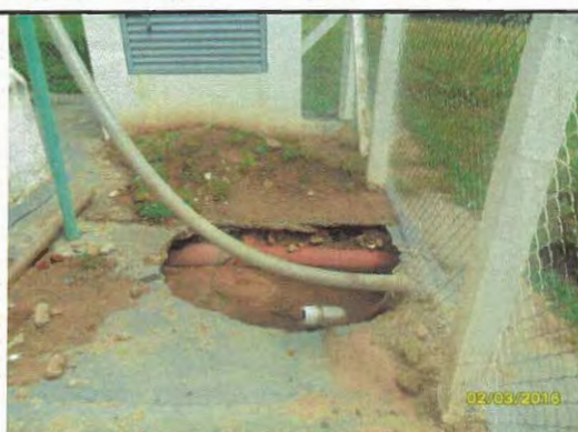
Foto 13 – Centro de reservação Cesar Neto: estrutura civil do piso danificada.
