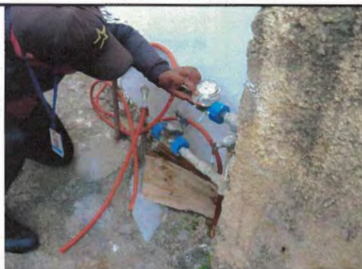
Foto 12 – Foi constatado que o hidrometro estava quebrado.
