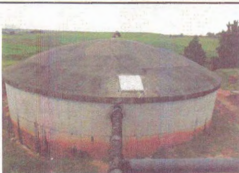
Foto 11 – ETA: Reservatório de água tratada – inexistência de lacre ou cadeado na tampa.
