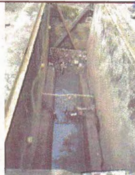
Foto 84 – EEE Jardim América: gradeamento danificado.
