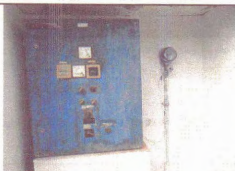
Foto 19 – Quadro de comando elétrico da EEAT.
