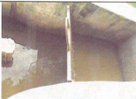
Foto 107 – ETE fossa filtro: gradeamento.
