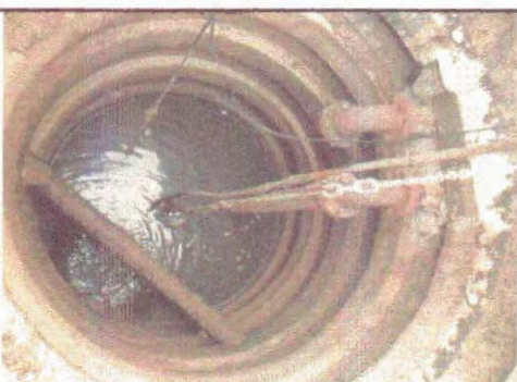
Foto 69 – EEE Jardim Botucatu I: poço de sucção.
