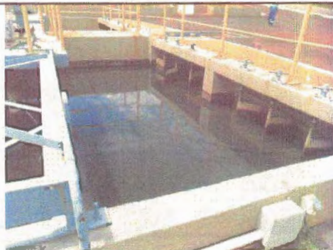
Foto 102 – ETE Lageado:desarenador parado.
