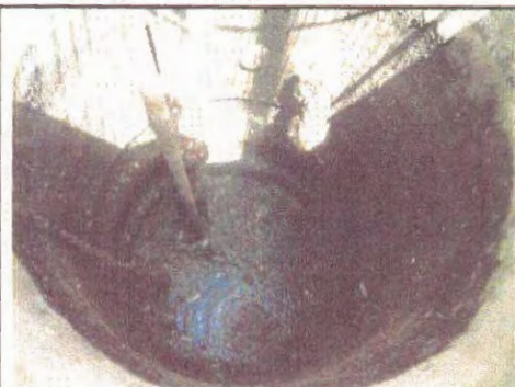
Foto 112 – EEE: poço de sucção.
