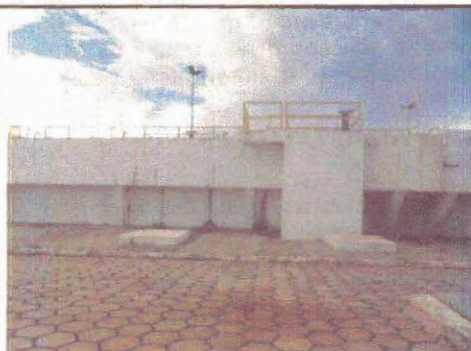
Foto 4 – ETA: decantadores e filtros.
