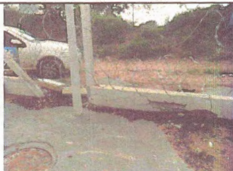
Foto 80 – EEE Nossa Senhora Aparecida: estrutura civil – cerca danificada.
