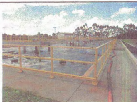
Foto 104 – ETE Lageado:tanques de aeração.
