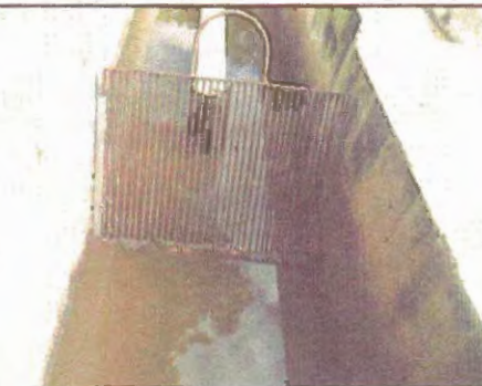
Foto 106 – ETE fossa filtro; gradeamento.
