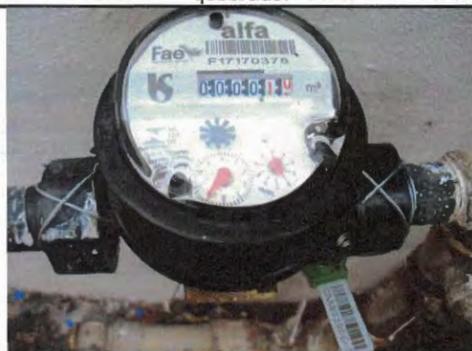
Foto 14 – O hidrometro instalado está devidamente numerado e lacrado com numero de identificação lançada na Solicitação de Serviço.
