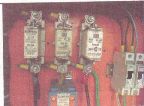
Foto 92 – EEE Santo Antonio do Cascatinha: quadro de comando elétrico.
