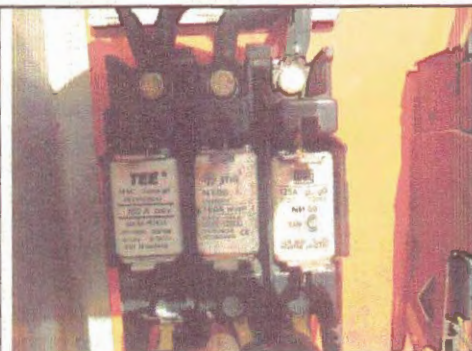
Foto 32 – EEE Havaí: partes vivas expostas e fusíveis com diferentes amperagens.
