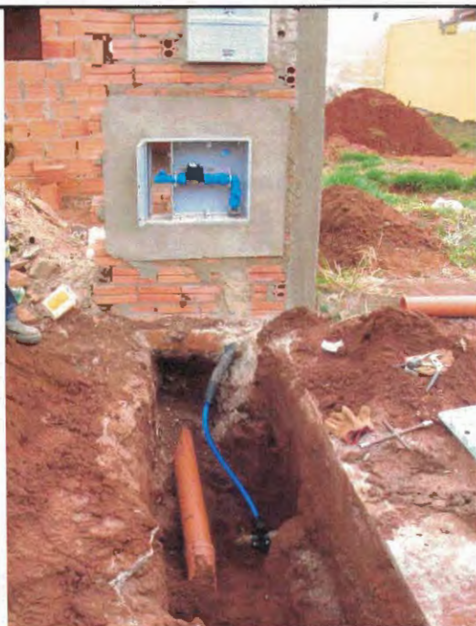
Foto 7 – Ligação de água e esgoto.
