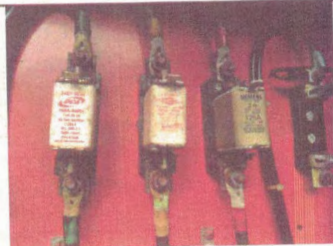
Foto 90 – EEE Jardim América: quadro de comando elétrico – partes vivas expostas e fusíveis com diferentes amperagens, conjunto: 160A, 125A e 125A.
