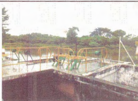
Foto 1 – Captação: manancial superficial.
