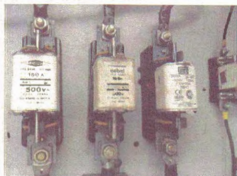
Foto 60 – EEE Jardim Paraíso II- Quadro de comando elétrico - partes vivas expostas.
