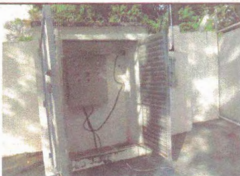
Foto 67 – EEE Bela Vista: fio elétrico da boia de nível do poço de sucção.
