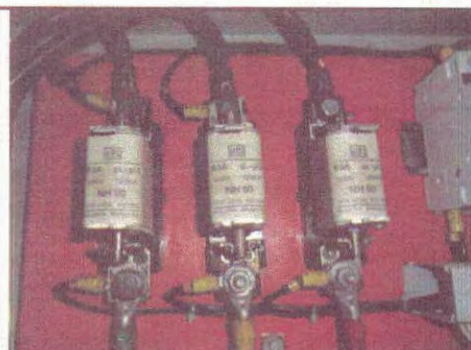
Foto 30 – Poço de Vitoriana: Quadro de comando elétrico - partes vivas expostas.
