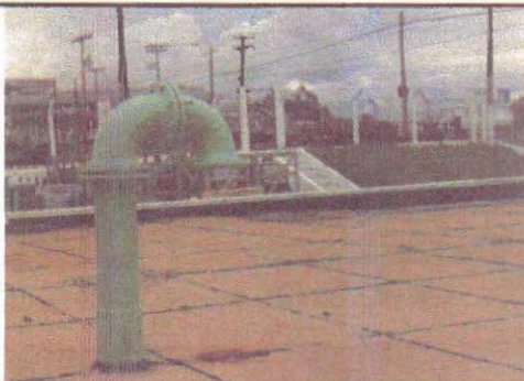
Foto 9 – ETA: Inexistência de proteção nos respiros do reservatório apoiado de água tratada da ETA.
