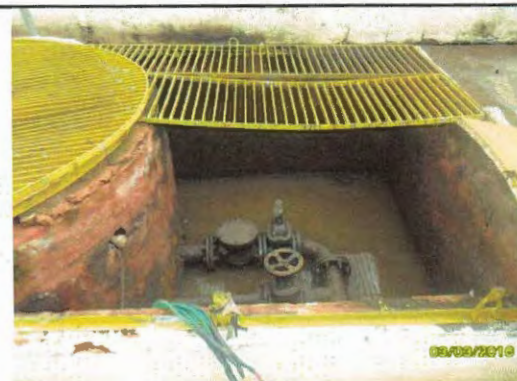
Foto 28 – ETE Jardim Riviera: cavalete.
