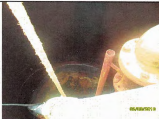
Foto 16 – ETA Rio Bonito - Caixa de contato.
