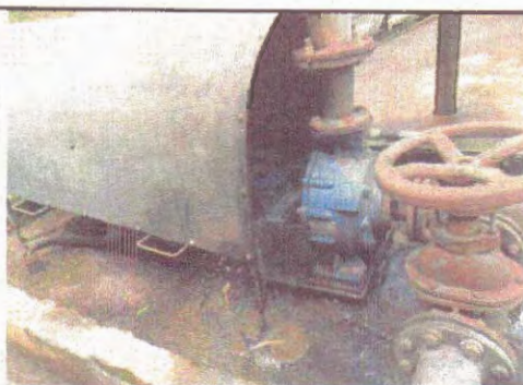
Foto 63 – EEE Monte Mor: vazamento de esgotos através da gaxeta
