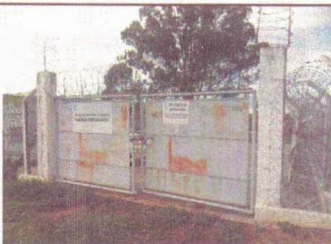
Foto 37 – EEE Jardim aeroporto: vista geral.
