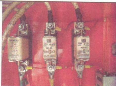
Foto 96 – EEE Dist. Industrial II: quadro de comando elétrico.
