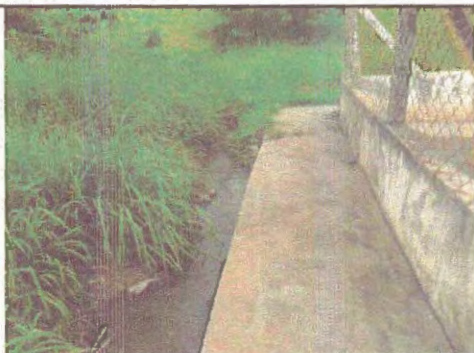
Foto 41 – EEE Jardim Riviera: extravazamento de esgotos.
