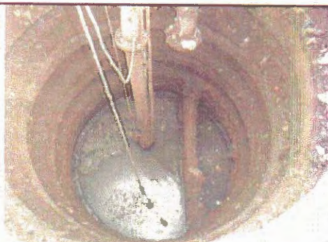
Foto 72 – Jardim Botucatu II: poço de sucção.
