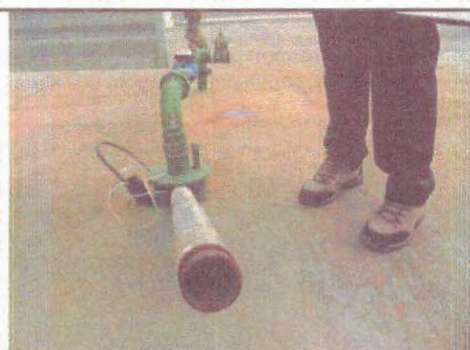
Foto 14 – Poço P4: instalação improvisada.
