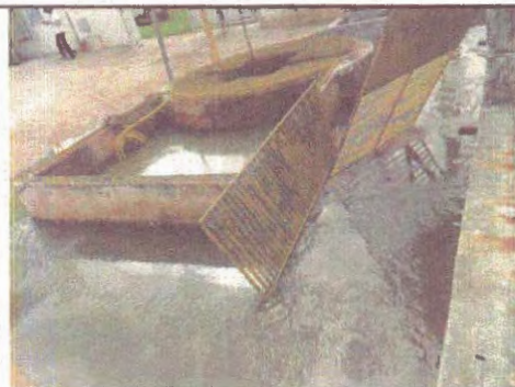
Foto 42 – EEE Jardim Riviera: extravazamento de esgotos.
