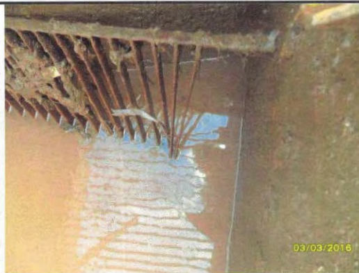
Foto 30 – EEE Jardim Riviera: extravazamento de esgotos.
