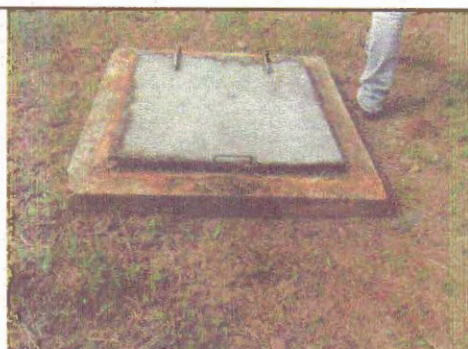
Foto 108 – ETE fossa filtro tampa oxidada.
