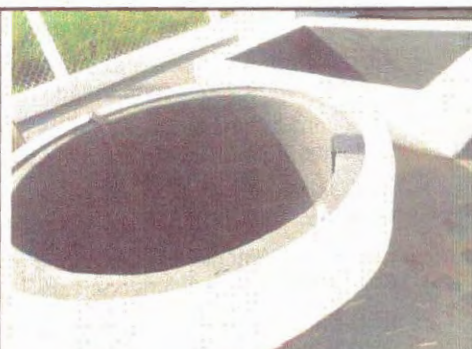
Foto 34 – EEE Convívio: poço de sucção sem proteção.
