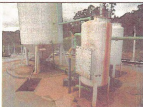
Foto 16 – Filtros oxidados e vazando água.
