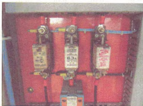
Foto 64 – EEE Monte Mor: quadro de comando: partes vivas expostas e fusíveis com diferentes amperagens
